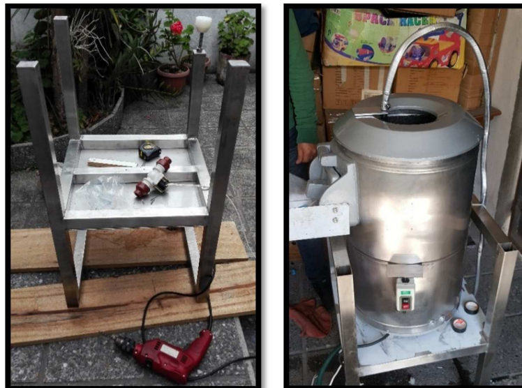
Figura 153 Colocación electroválvula (izquierda), manguera en forma de arco (derecha)
