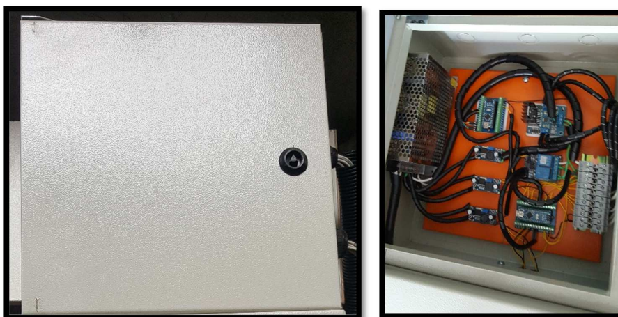
Figura 168 Cableado gabinete de control
