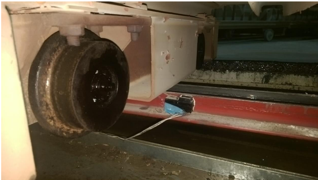
Figura 59 sujeción de fines de carrera
