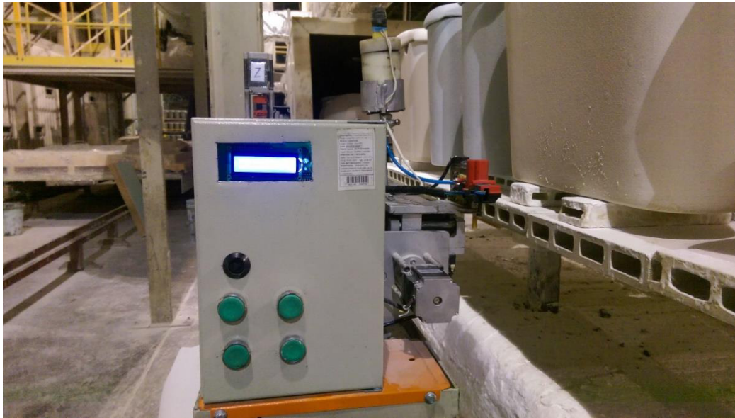
Figura 60 Caja de control
