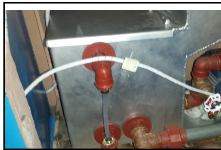
Figura 138 Prueba del indicador de nivel.
