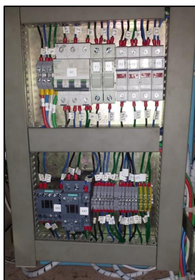
Figura 109 Parte delantera del Tablero de control.
