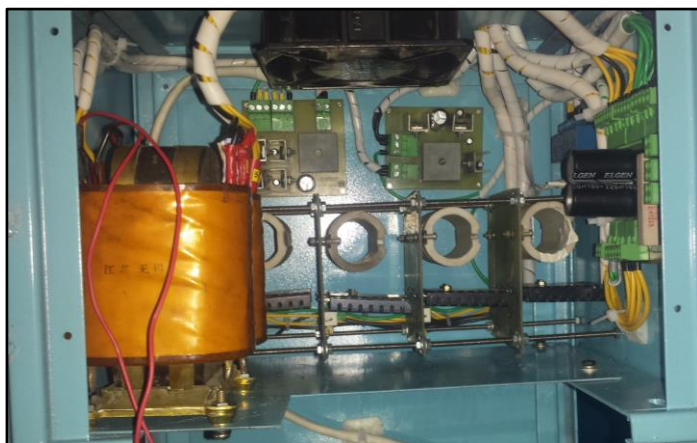
Figura 130 Ubicación y cableado de las placas electrónicas de la chispa.
