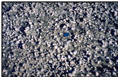
Figura 13. Desprendimiento de material en la capa de rodadura.
