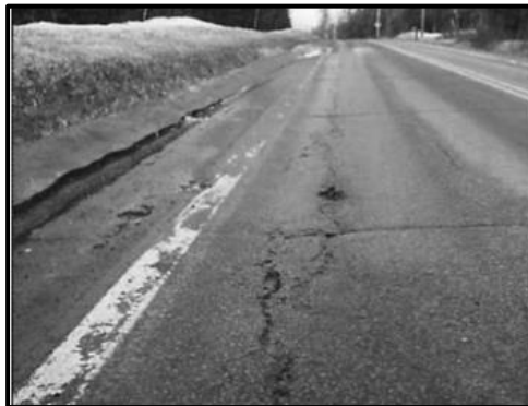
Figura 14. Pavimento con baches en la calzada.
