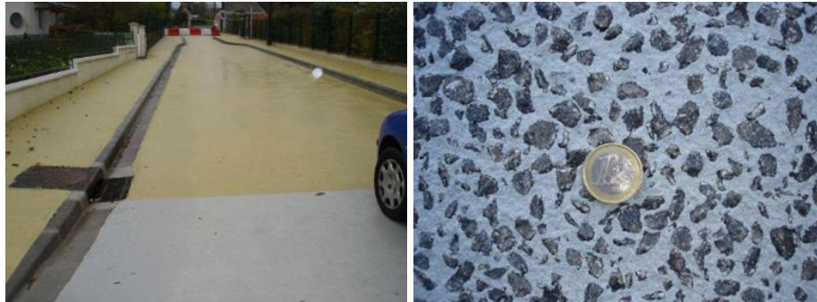
Figura 135. Superficie de rodadura. Izq.- Filtración de la lechada antes; Der.- después del granallado.
