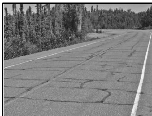
Figura 7. Grietas transversales en un pavimento.
