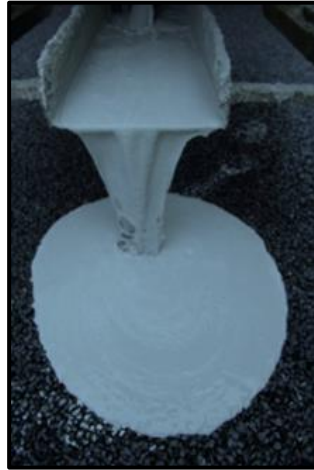
Figura 134. Filtración o percolación de lechada especial sobre la capa de mezcla bituminosa drenante.
