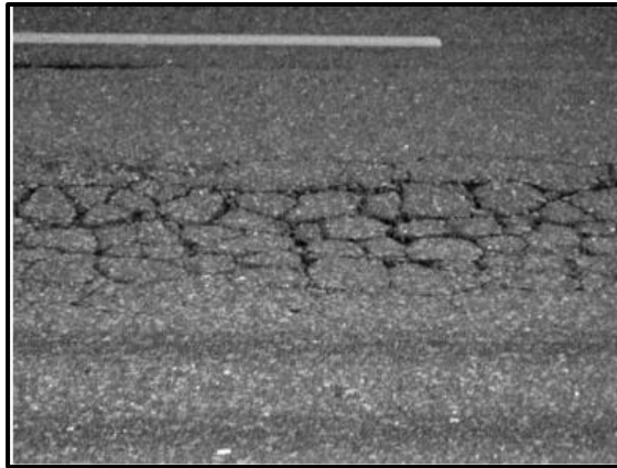
Figura 9. Agrietamiento por fatiga en pavimentos
