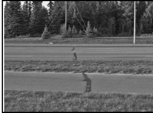
Figura 8. Grietas por gradiente térmico.
