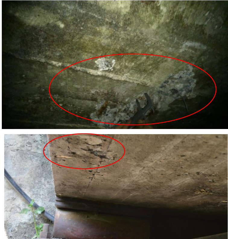
Figura 28 Perdida de recubrimiento
