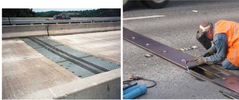
Figura 24: Juntas de Dilatación para controlar el efecto de la temperatura
