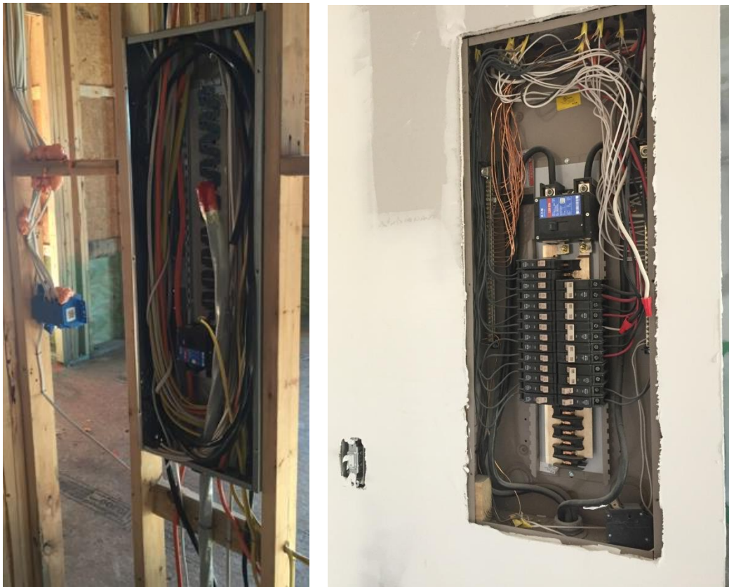
Figura 114: instalaciones eléctricas colocadas en pared enmarcada y luego recubierta con gypsum
