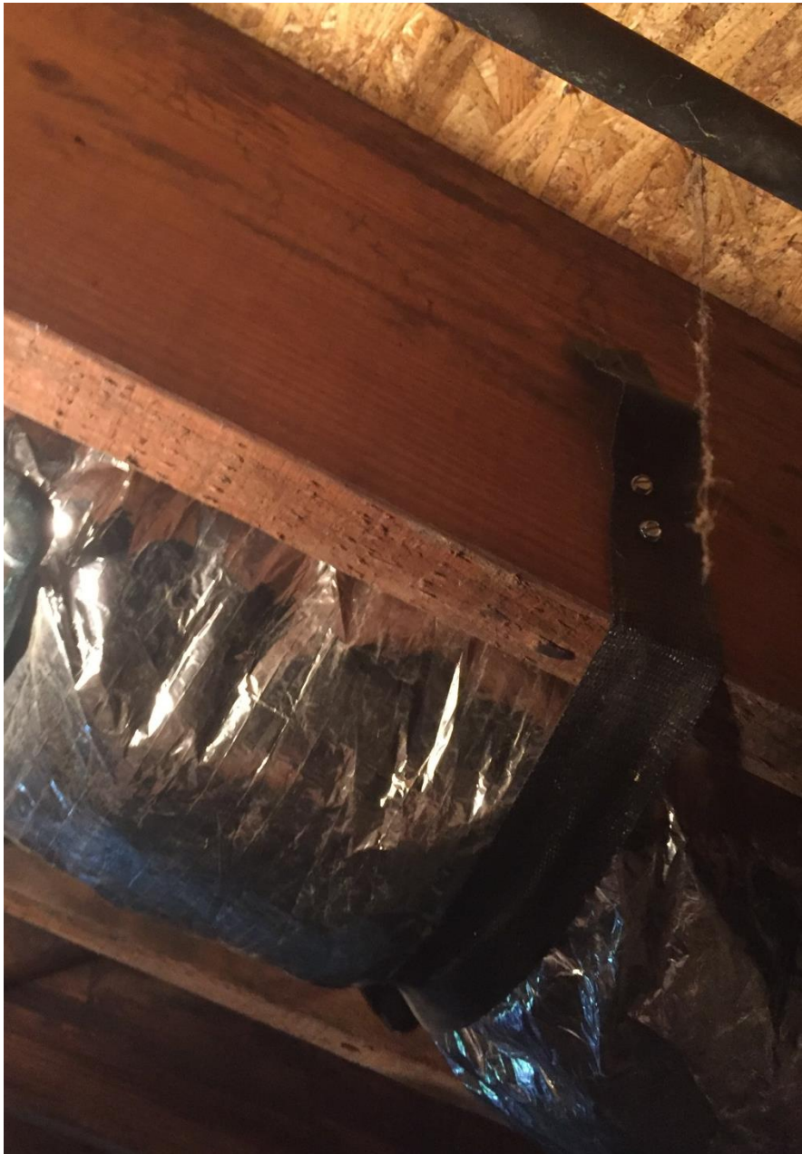
Figura 112: Ducto de aire acondicionado entre viguetas de techado.
