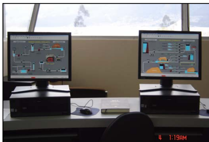
Figura 1.9 Terminales SCADA Bellavista
