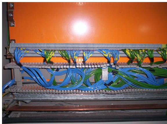
Figura 5.13 Cableado de señales de alarmas hacia bornera en Estación Recuperadora.
