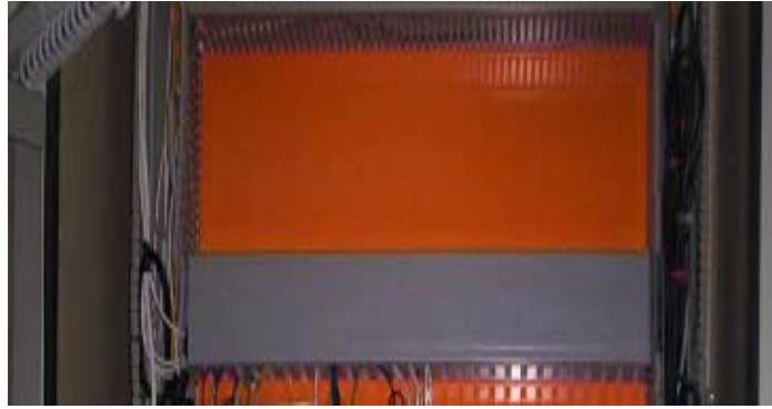
Figura 5.14 Panel SCHORCH #6 Parte Frontal Superior Estación Recuperadora
