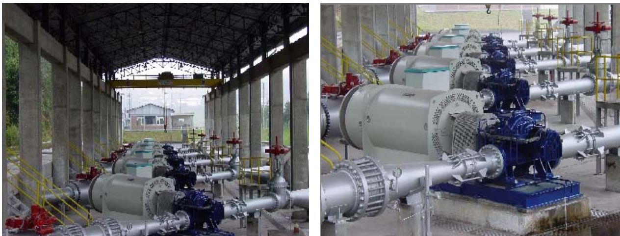
Figura 1.4 Estación Booster I
