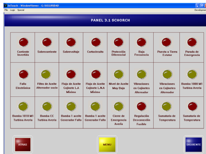
Figura 4.66 Pantalla SCADA de alarmas del panel SCHORCH # 3.1 de la Estación Recuperadora.
