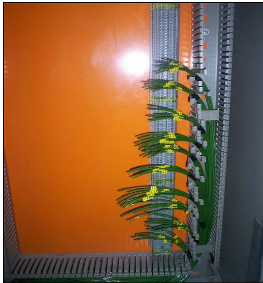
Figura 5.15 Panel SCHORCH #7 Parte Trasera Estación Recuperadora
