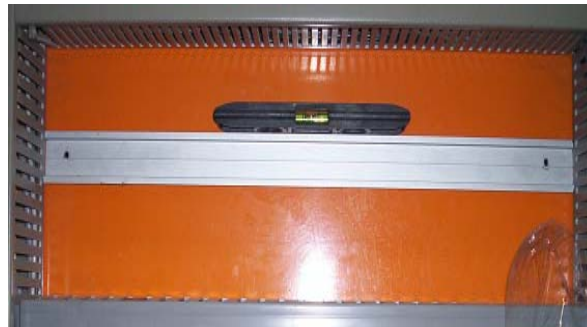
Figura 5.1 Panel SCHORCH #2 Parte Frontal Superior Estación Elevadora.
