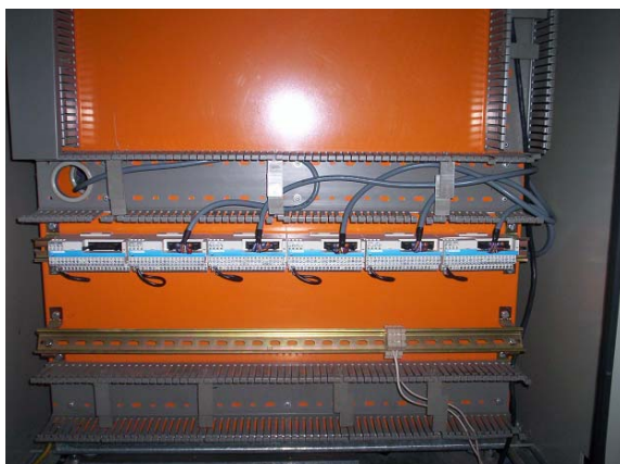
Figura 5.7 Montaje de borneras Telefast en Estación Booster I.
