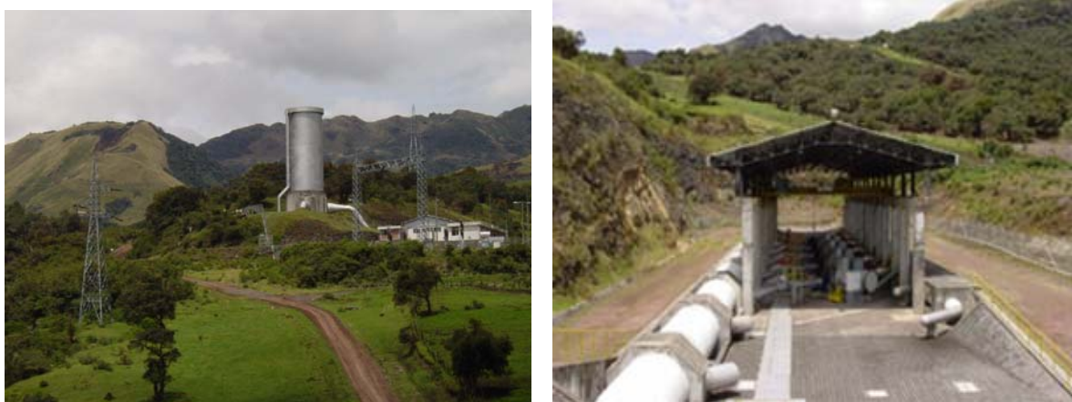
Figura 1.5 Estación Booster II
