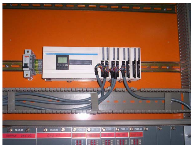
Figura 5.6 Montaje del PLC Twido en Estación Booster I.
