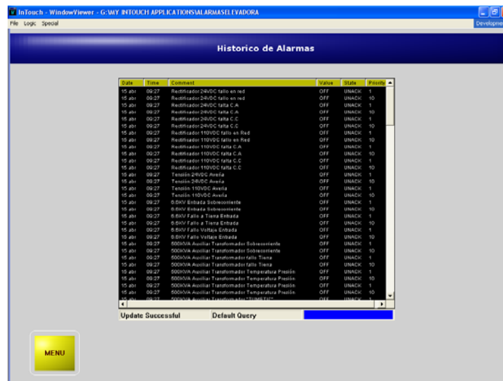
Figura 4.70 Pantalla SCADA de histórico de alarmas Estación Recuperadora.
