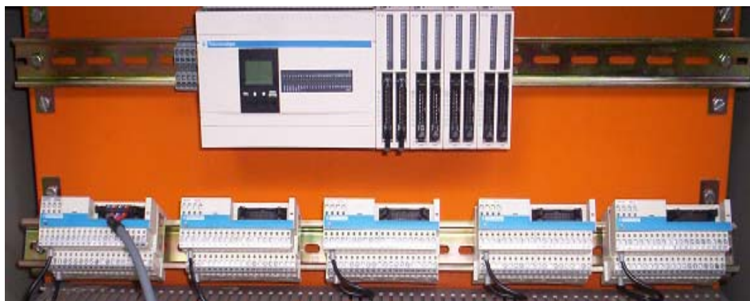
Figura 5.10 Montaje del PLC Twido y Borneras Telefast en Estación Booster II.
