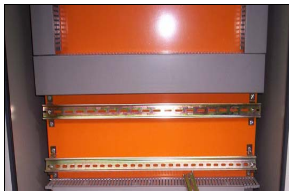
Figura 5.2 Panel SCHORCH #2 Parte Posterior Superior Estación Elevadora.
