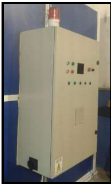
Figura 108. Ubicación del gabinete modular
