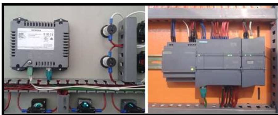
Figura 116. Montaje del panel de operador y PLC
