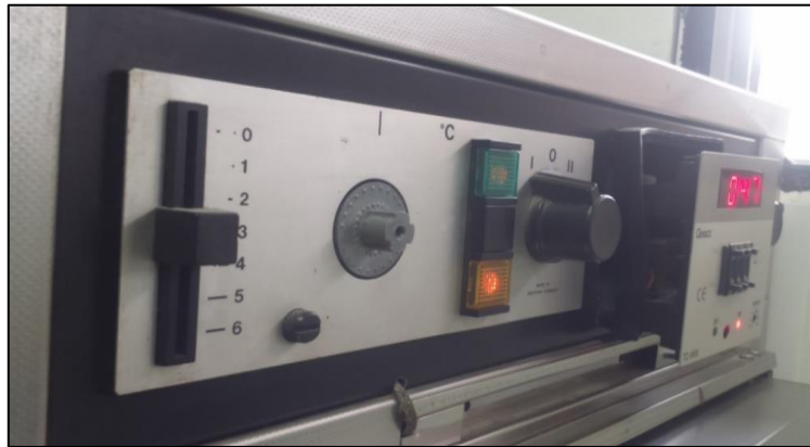
Figura 34 Instalación final del panel de control
