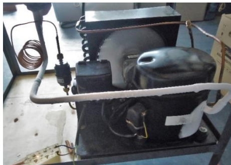
Figura No. 36. Unidad condensadora en funcionamiento.
