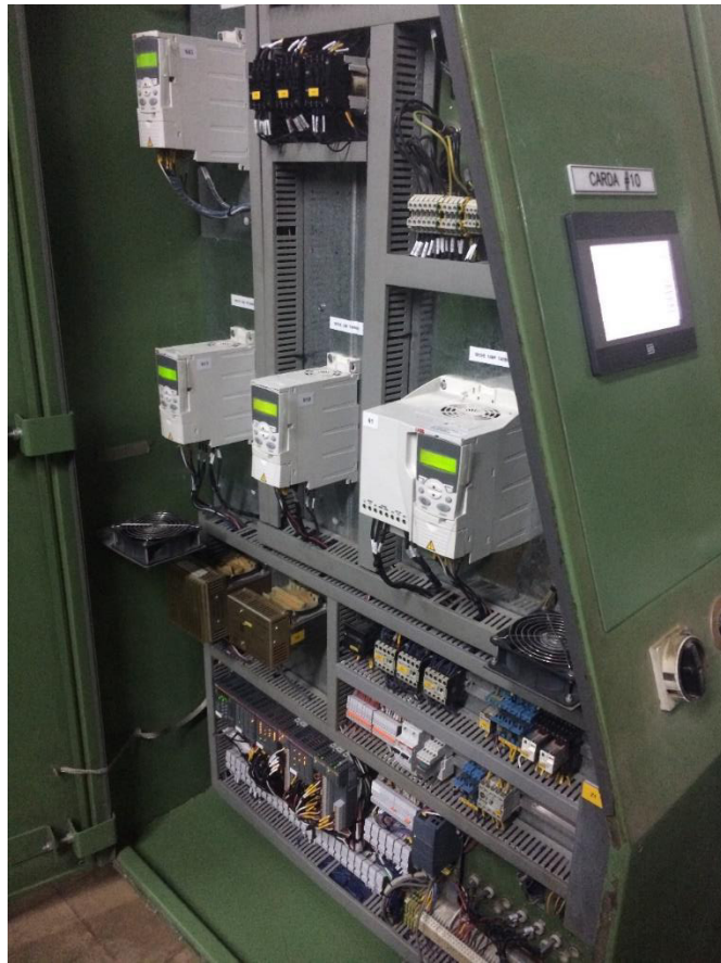
Figura 149 Etiquetado completo tablero eléctrico principal de control.
