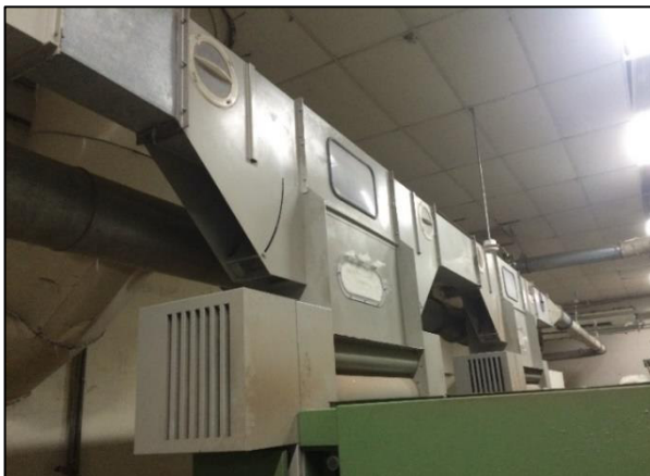
Figura 10 Sistema de ductos turbinados hacia las máquinas cardas
