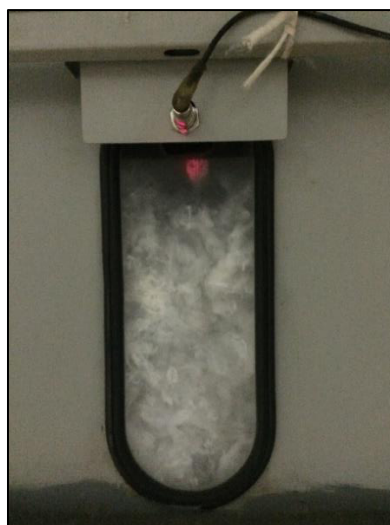
Figura 136 Sensor de nivel reflectivo antiguo en el silo
