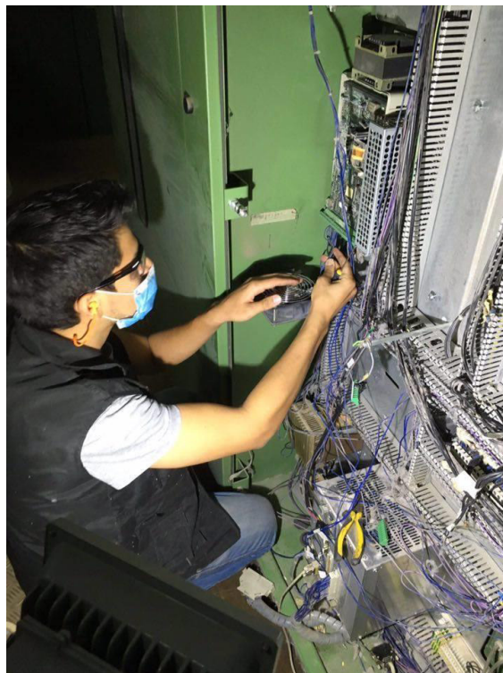
Figura 122 Identificación de señales en el Tablero Principal
