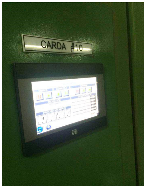
Figura 146 Comprobación de funcionamiento de la pantalla HMI.
