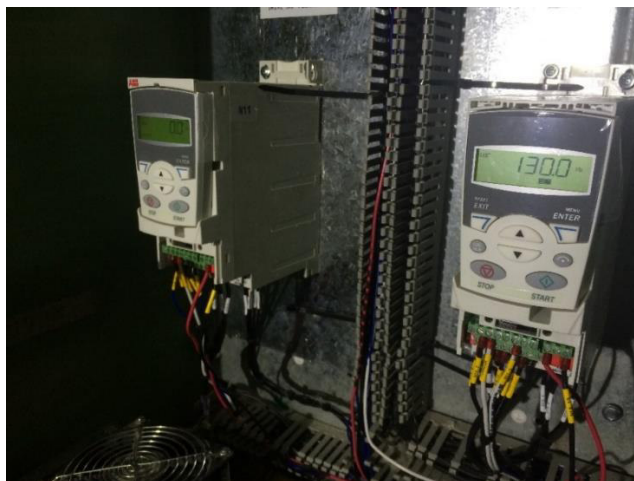
Figura 147 Comprobación de funcionamiento del Variador de Frecuencia Fuente: Propia
