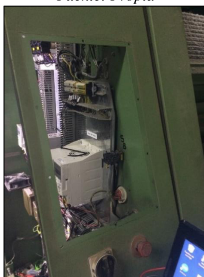
Figura 134 Espacio libre al retirar el antiguo panel en el tablero principal.
