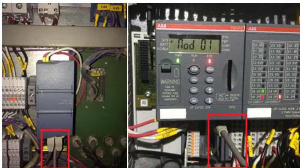
Figura 156 Switch Siemens CSM 1277 y PLC con su comunicación Ethernet
