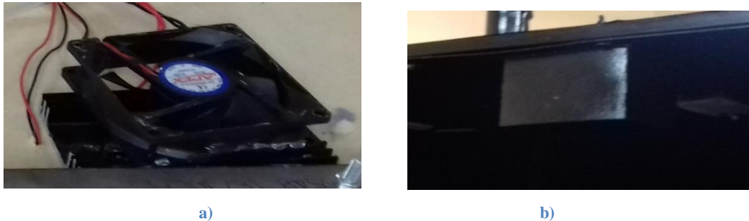
a) b) Figura 72 Construcción e instalación del subsistema de aire acondicionado (a) Conjunto de aire acondicionado, (b) Caja de protección del sistema de aire acondicionado
