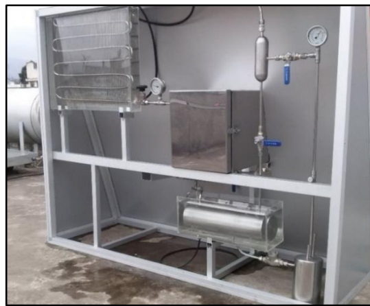
Figura 45: Manómetros instalados en el sistema de refrigeración
