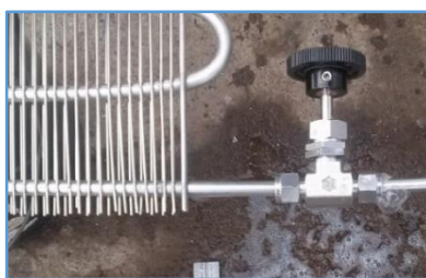
Figura 47: Fuga en conexión de la válvula de expansión
