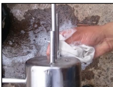
Figura 48: Fuga en junta soldada del intercambiador de calor
