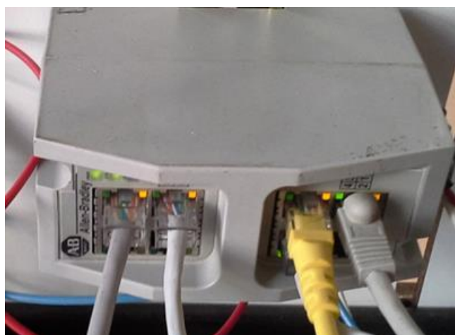
Figura 163 Verificación del Switch industrial
