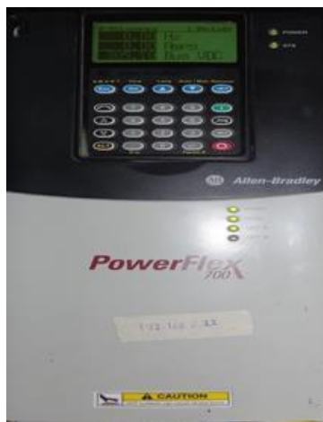
Figura 31 VSD Variador Powerflex 700
