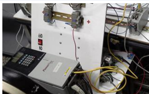
VSD variador PowerFlex 700 en el switch
