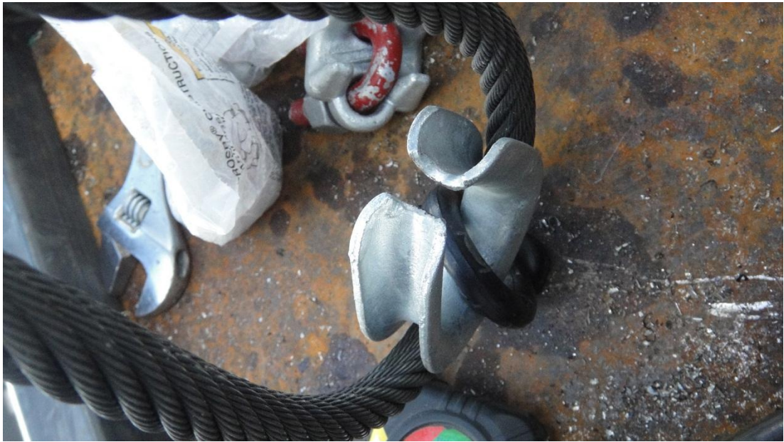
Figura 101 Instalación de los cables de tracción en conjunto con el guarda cable
