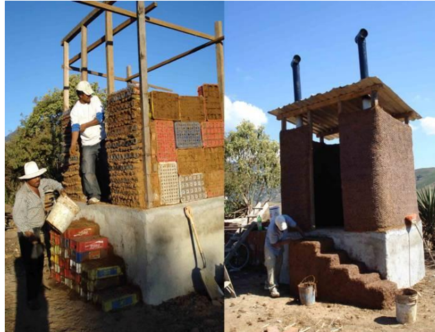
Figura 33. Estructura externa del baño de compostaje Fuente: (Rodríguez, 2015)
