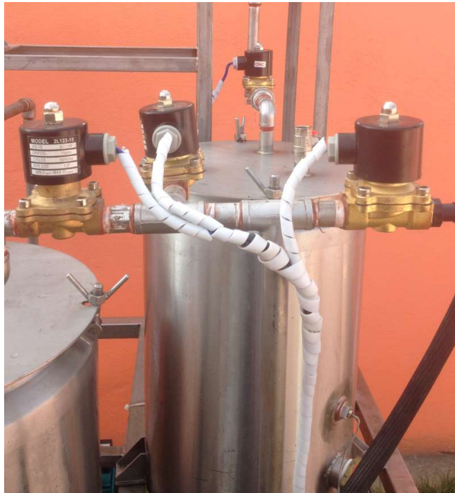
Figura 87 Conexiones de los actuadores al tablero
