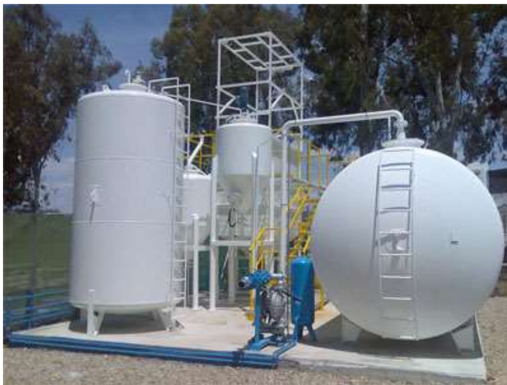
Figura 6 Reactor de biodiésel de ciclo continuo
