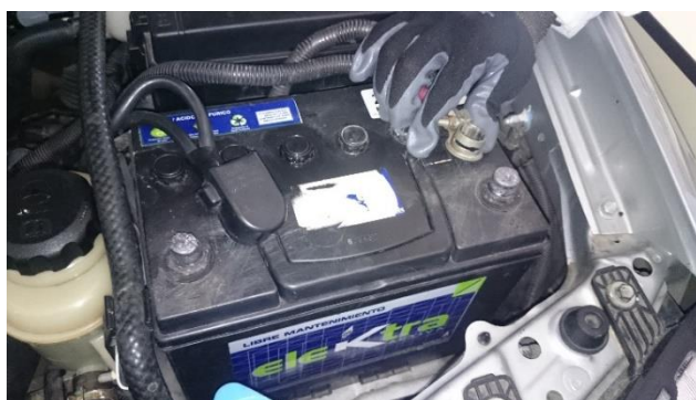
Figura 125 Desconexión de la alimentación eléctrica del vehículo
