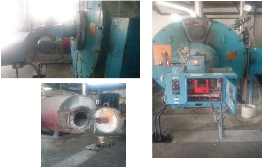
Figura 16: Quemador de encendido
