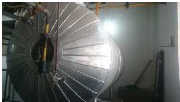
Figura 18: Tanque de condensado-alimentación de agua
