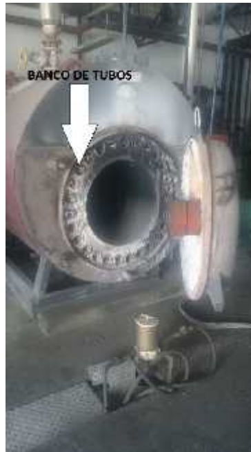
Figura 15: Banco de tubos
