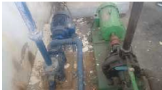
Figura 20: Bombas de alimentación de agua al Caldero
