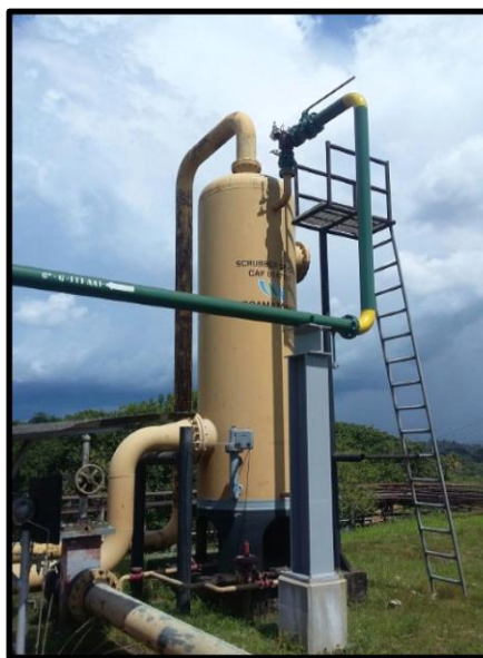
Figura 25 Scrubber para tratar el gas de alta presión
