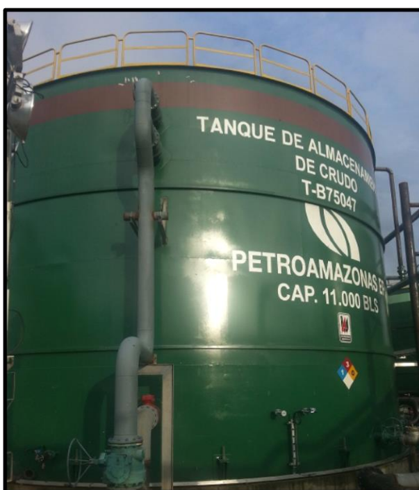
Figura 20 Tanque de almacenamiento de crudo
