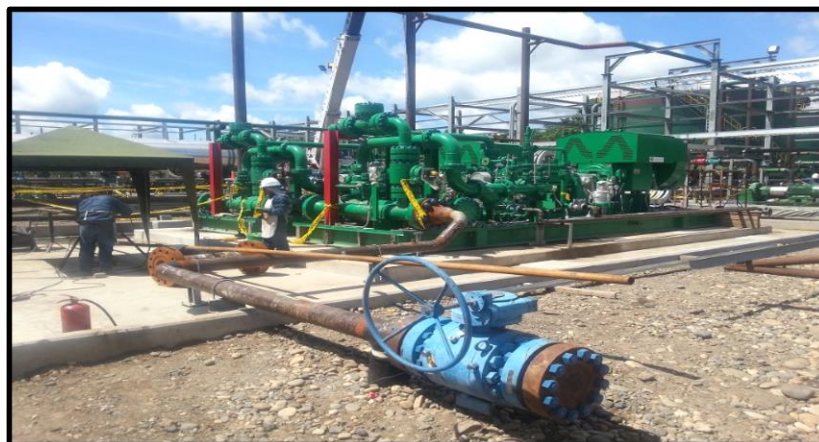
Figura 16 Bombas de reinyección de agua
