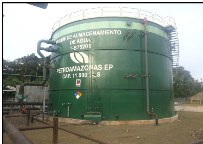
Figura 14 Tanque de almacenamiento de agua
