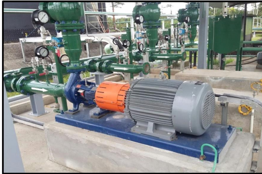
Figura 21 Bombas booster de crudo
