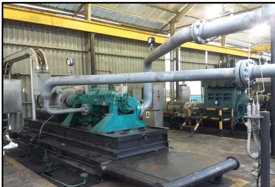
Figura 22 Bombas de transferencia de crudo
