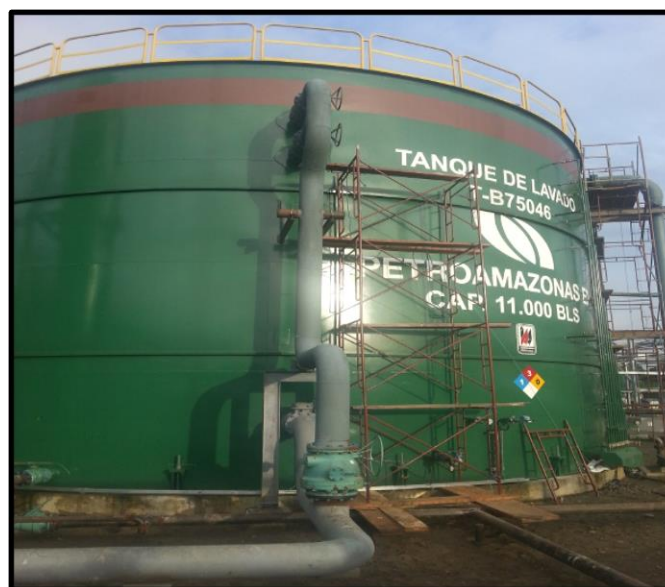
Figura 19 Tanque de lavado
