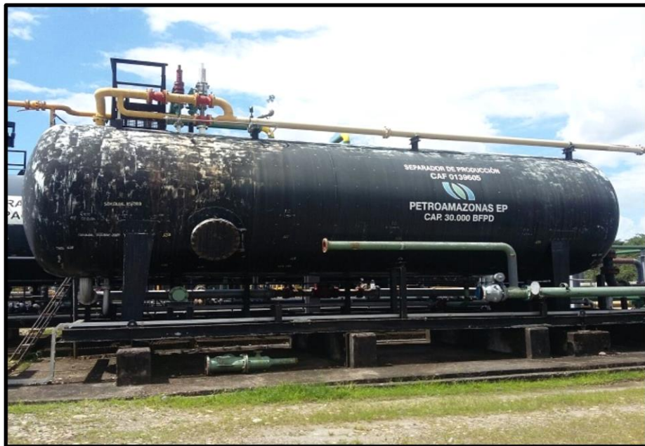
Figura 10 Separador trifásico cap. 30000 bpd
