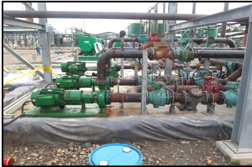
Figura 15 Bombas booster de agua
