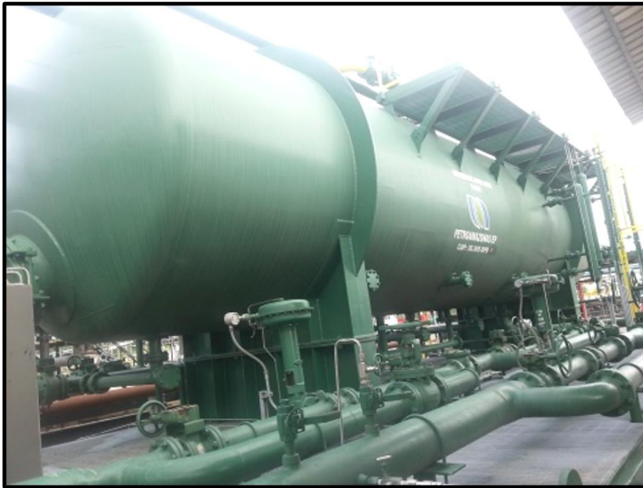
Figura 9 Separador libre de agua fwko cap. 120000 bpd
