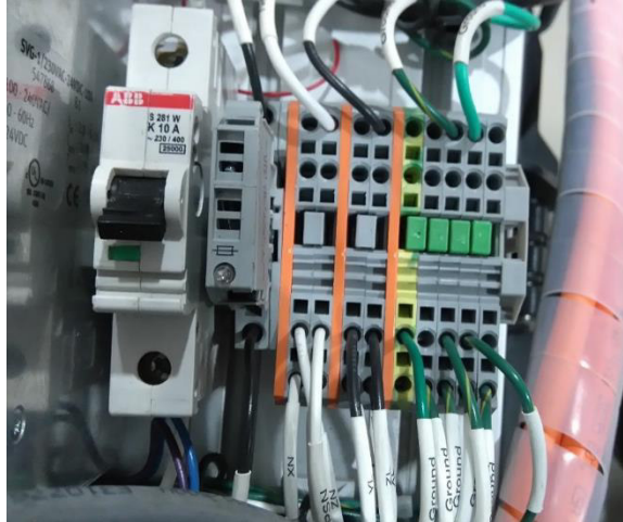
Figura 183. Borneras placa de control
