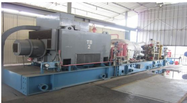
Figura 23 Turbina TB2 de 3 MW
