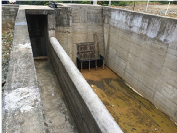
Figura 13: Tanque de carga
