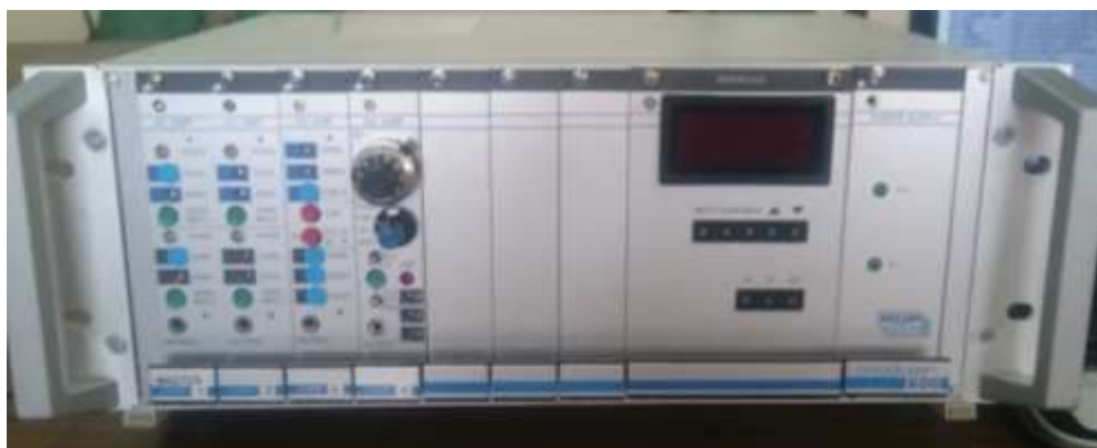
Figura 55 Acondicionador RDP Datalogger
