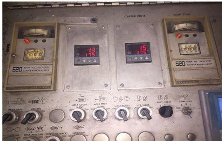
Figura 46 Reemplazo de controles de temperatura.
