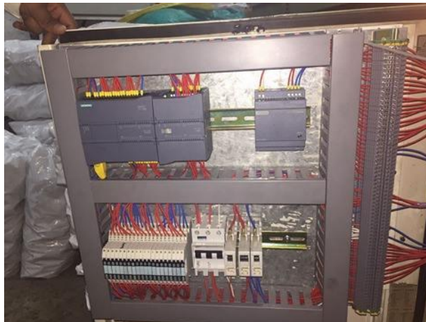
Figura 64 Distribución de cableado.
