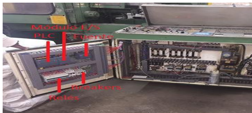
Figura 51 Ubicación de controlador y componentes varios.
