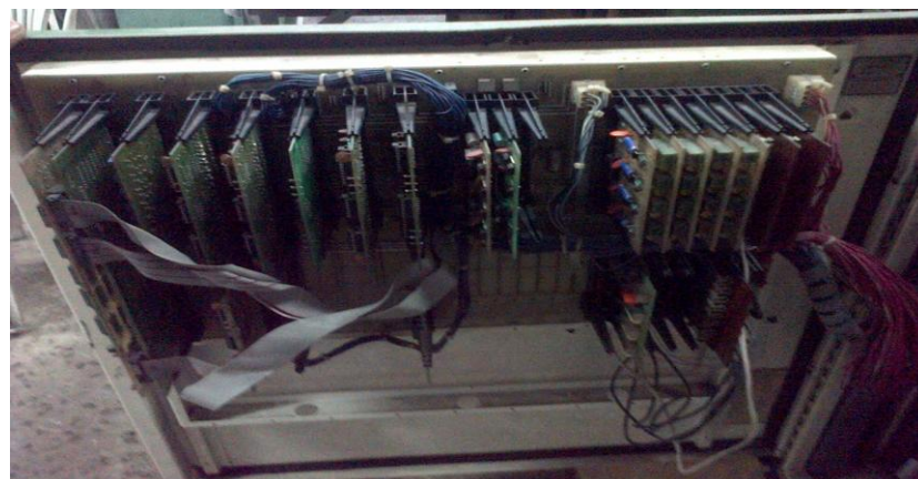
Figura 25 Placas controladoras dañadas de máquina Van Dorn.
