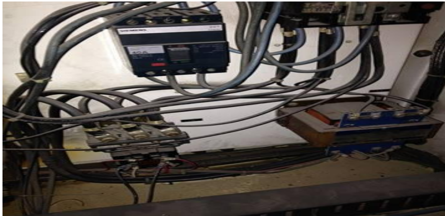
Figura 55 Ubicación contacto principal de bomba, disyuntor y transformador para control de temperatura.
