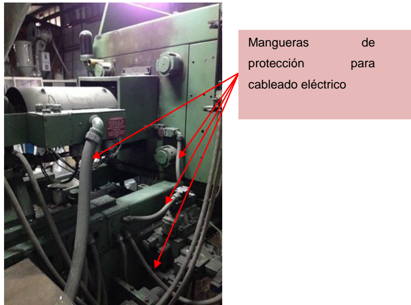
Figura 65 Manguera de protección para cableado eléctrico.
