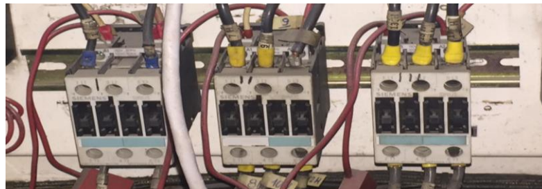
Figura 23 Contactores control de temperatura máquina Van Dorn.
