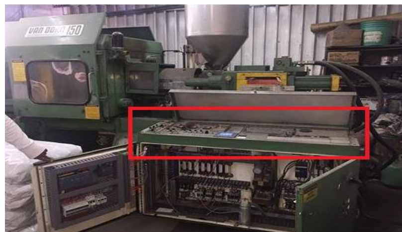
Figura 58 Ubicación mando y HMI máquina inyectora.
