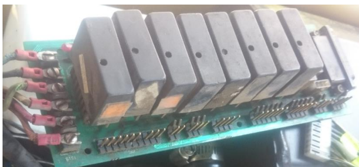
Figura 54 Placa de control de electroválvulas en mal estado
