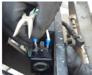
Figura 74 Cambio de Electroválvulas
