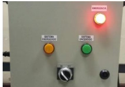
Figura 70 Indicador de sistema detenido por pulsador de emergencia
