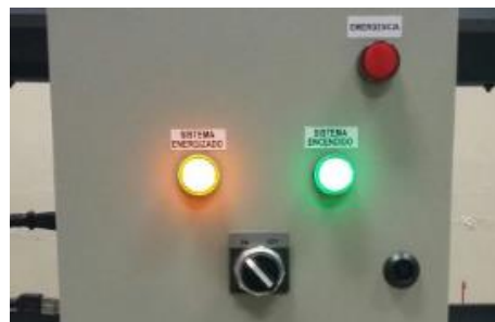
Figura 69 Indicadores de sistema energizado y encendido
