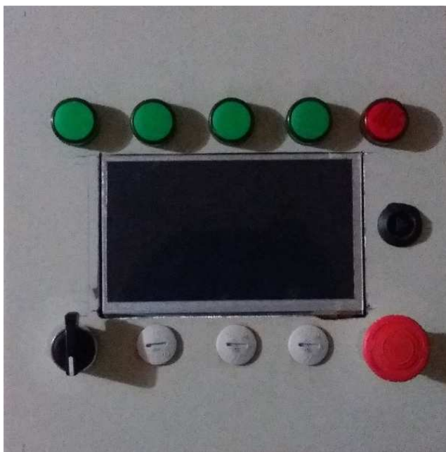
Figura 70 Panel caja eléctrica
