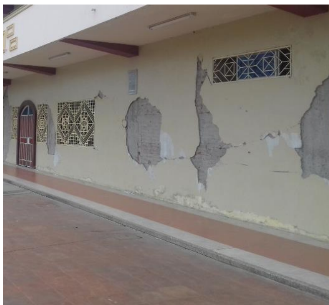
Figura. 5. Desprendimiento de recubrimientos de columnas en planta baja
