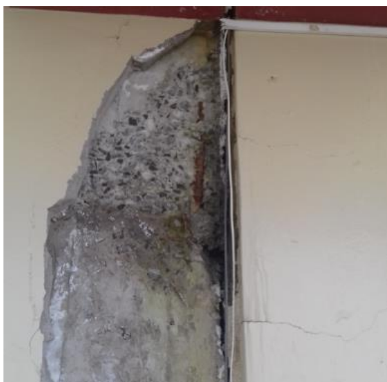
Figura. 3. Varilla expuesta en columna
