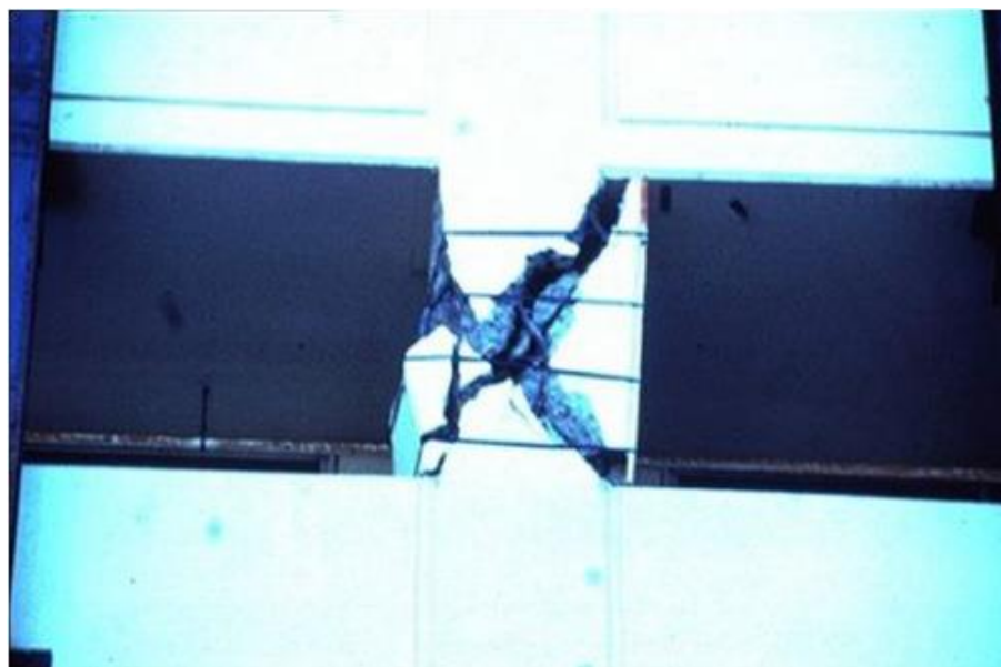
Figura. 12. Falla de una columna corta, Santa Monica, 1994
