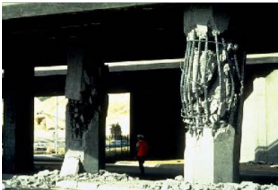
Figura. 8. Terremoto de 1971, San Fernando, California
