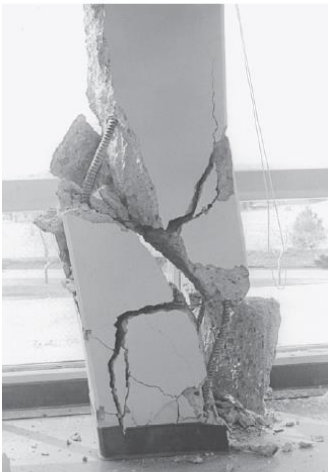
Figura. 11. Agrietamiento diagonal producto del corte producido por el sismo
