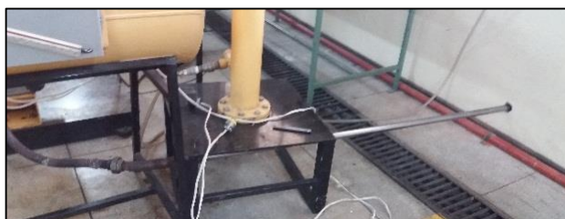
Figura 63: Tubo de escape hacia el exterior.
