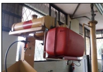
Figura 60: Tanque de combustible.
