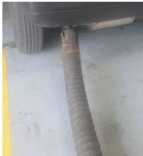
Figura 14: Vehículo anclado, con difusor de gases
