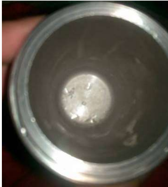
Figura 33: Gota de agua dentro de la bomba
