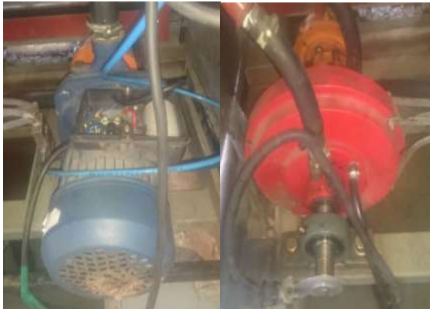
Figura 17: Conexión bomba de agua
