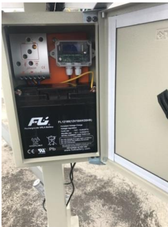
Figura 102 Componentes colocados en el gabinete metálico
