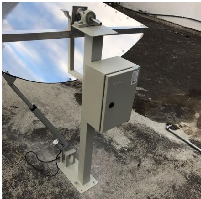
Figura 100 Gabinete colocado en la columna norte
