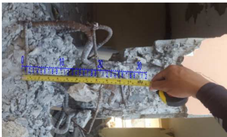
Figura 24 Daño evidenciado en pie de columna por el terremoto 16-A, Manabí
