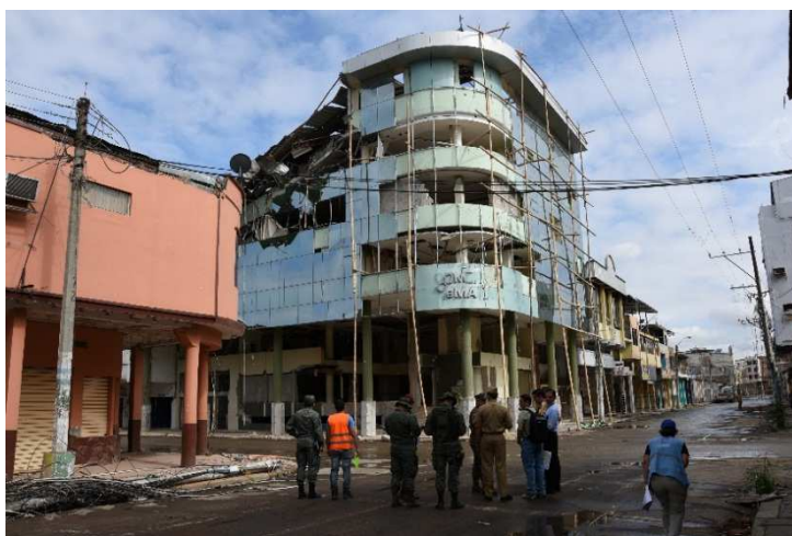
Figura 23 Observación a infraestructura afectada por el terremoto 16-A, Manabí
