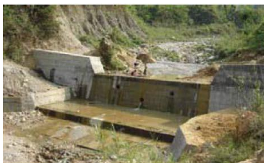
Figura 21 Presa vertical con pasos de agua. (Khahare Khola, Nepal)
