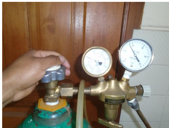
Figura No. 36. Tanque de oxígeno
