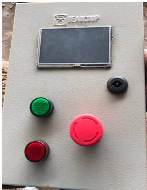
Figura 66. Vista frontal del panel de control
