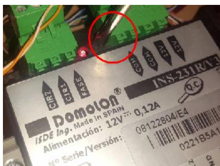
Figura 52. Cortocircuito del pin de servicio
