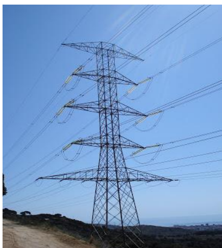
Figura 5: Cables de transmisión eléctrica de Aluminio
