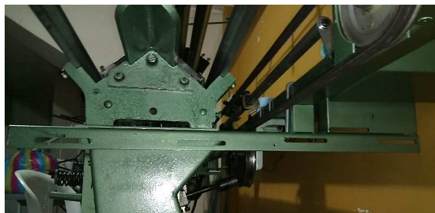
Figura 113 Estructura de soporte del sistema motriz instalado en la máquina
