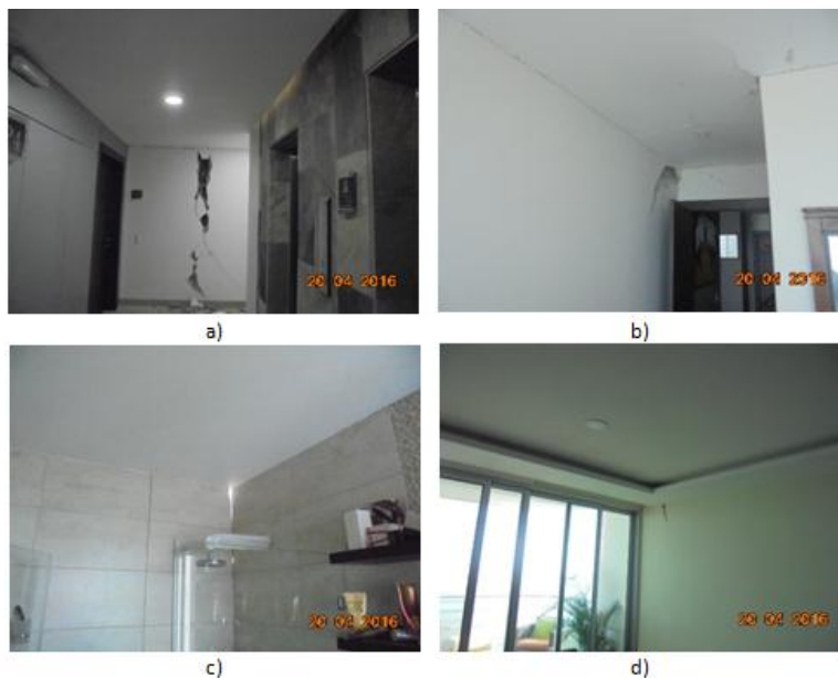
Figura 2 Daños registrados. Fuente: (Aguir & Del Castillo, 2016).
