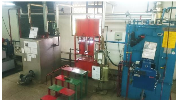
Figura 3 Planta de Vapor del LCEE
