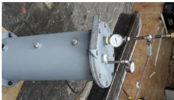
Figura 88 Prueba Hidroestática de Caldero
