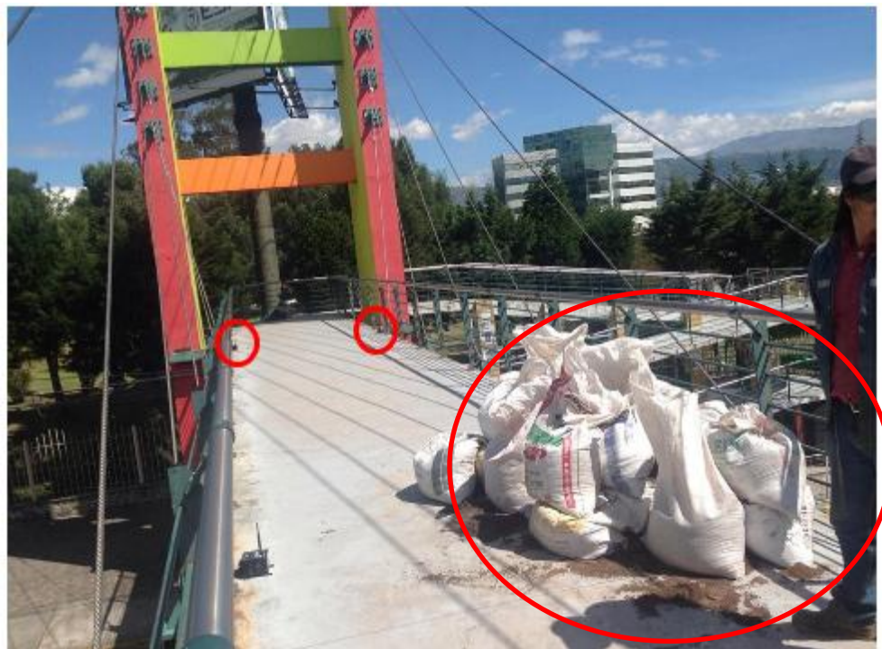
Figura 64 Colocación de Waspnote 3 y 4
