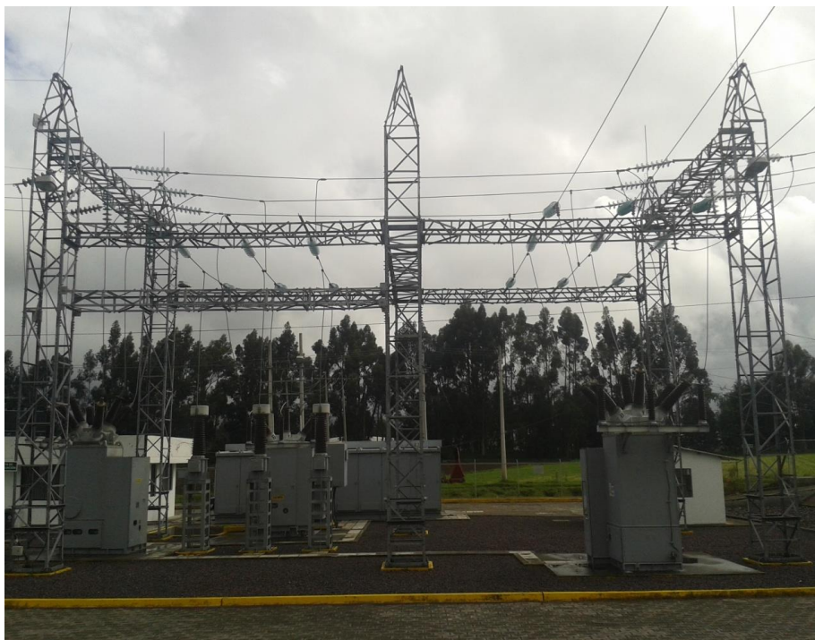
Figura 5 Subestación San Rafael
