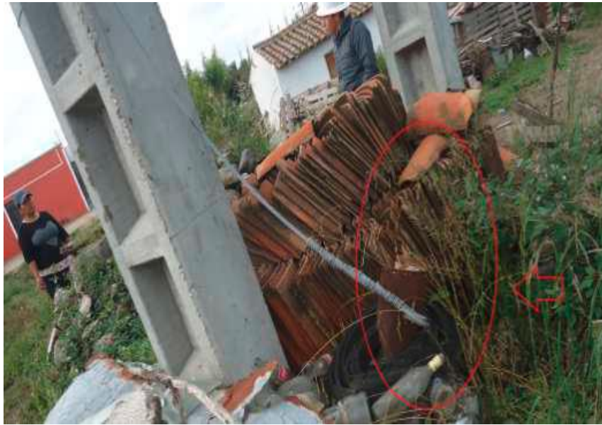
Figura 28 Puesta a tierra obstruida
