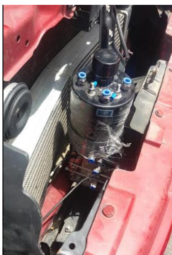
Figura 21. Lugar de instalación depósito del generador de hidrógeno
