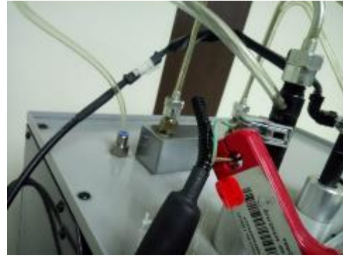
Figura 60. Conexión de la pinza amperimétrica
