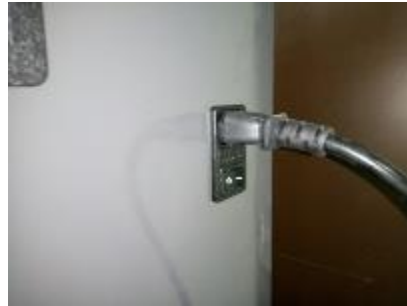
Figura 37. Cable de poder.
