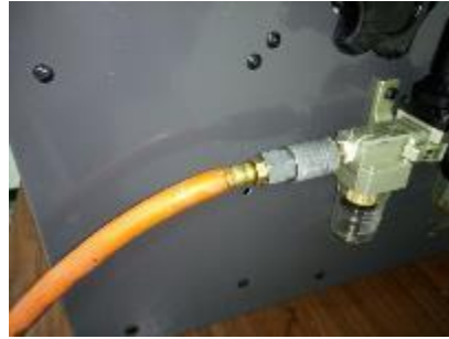
Figura 36. Ingreso de aire.
