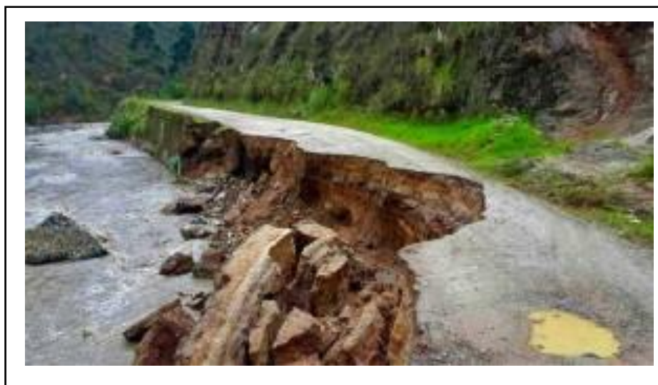
Figura 31: Inundación, carretera afectada.
