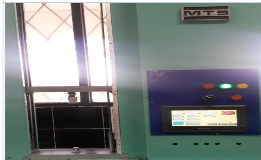
Figura 30 Adpatación y funcionamiento del tablero de control.
