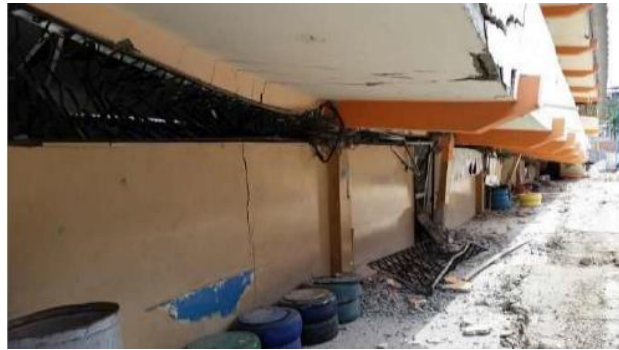
Figura 18 Columna corta debido a confinamiento por mampostería
