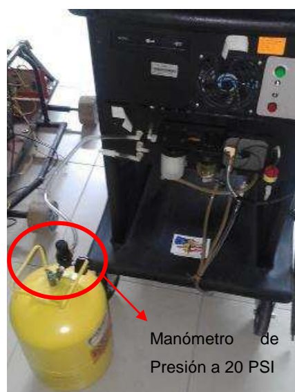
Figura 12. Calibración de gas de baja
