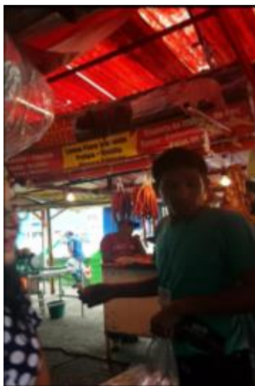
Figura 48 Feria César Chiriboga tiene techo en malas condiciones
