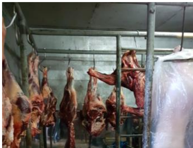
Figura 52 Las canales en el Mercado Chiriyacu cuelgan de tubos oxidados
