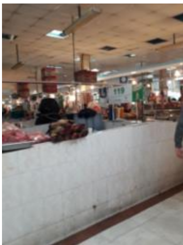
Figura 47 Mercado cerrado El Turismo tiene techo falso en malas condiciones
