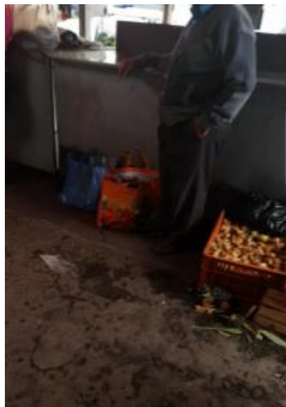
Figura 42 Feria César Chiriboga tiene el piso con grietas y roturas
